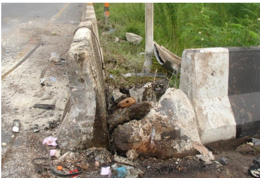
รูปที่ 3-9 ความเสียหายของกำแพงคอนกรีต
