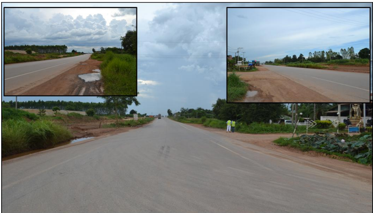
รูปที่ 11 สภาพถนน ณ ที่เกิดเหตุ
